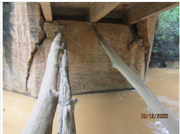
Figura 6. Vista do encontro, com taludes em estado crítico, muito deteriorados e com escoramento frágil sob a obra
