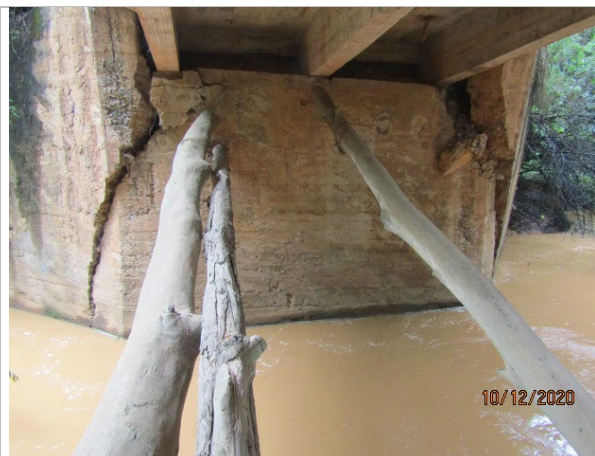
Figura 6 - Vista do encontro, com taludes em estado crítico, muito deteriorados e com escoramento frágil sob a obra
