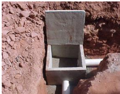
FIGURA 18 – CAIXA DE PASSAGEM
