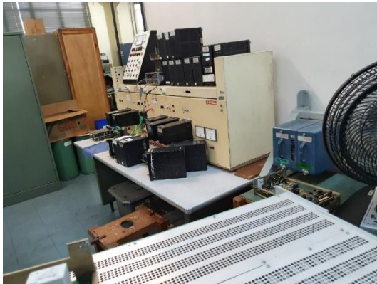
Figura 3-9 Giga de manutenção do Relé AC – Jeumont-Schneider
