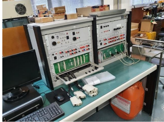
Figura 3-7 Giga de manutenção ATC/ATP Alstom
