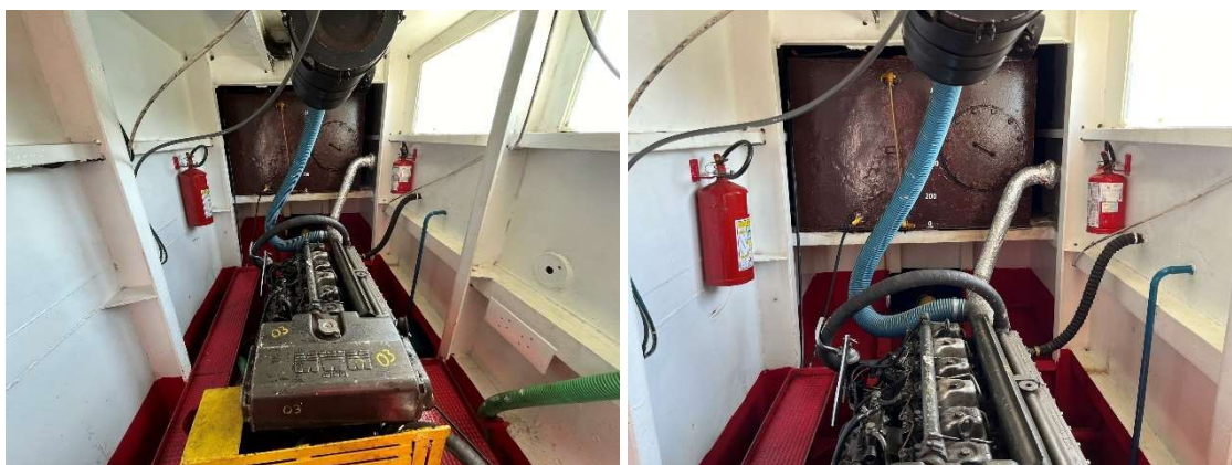
Figura 262 - Porto Fama - Balsa Araúna - Casa de Máquinas
