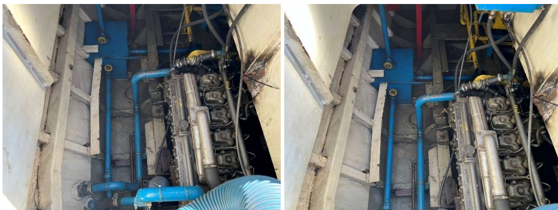
Figura 165 - Porto Itapiché - Balsa Fernandes – Casa de Máquinas
