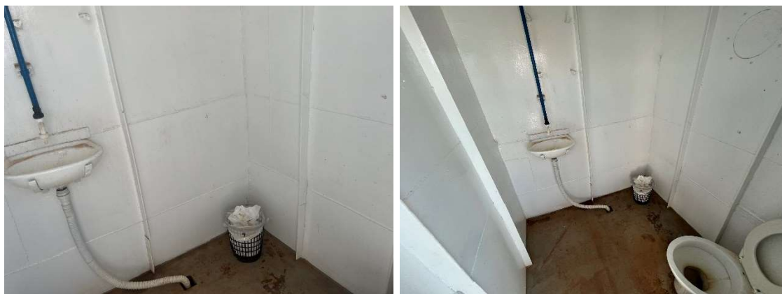
Figura 35 - Balsa São João Batista do Glória - Banheiro
