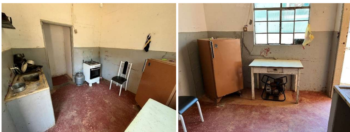
Figura 188 - Porto Itaci - Prédio Apoio - Cozinha - Margem Direita
