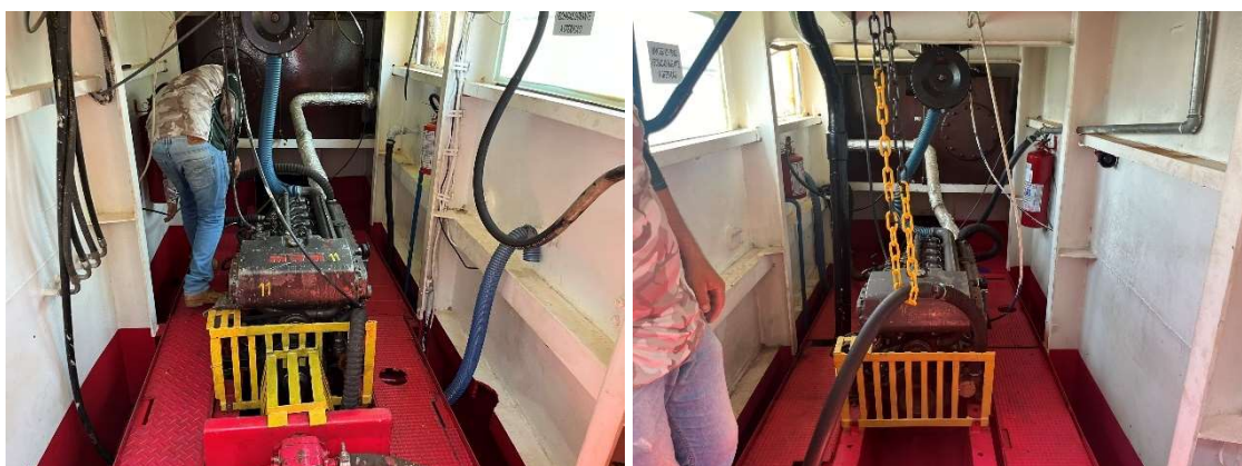
Figura 243 - Porto Harmonia - Balsa Fama - Casa de Máquinas
