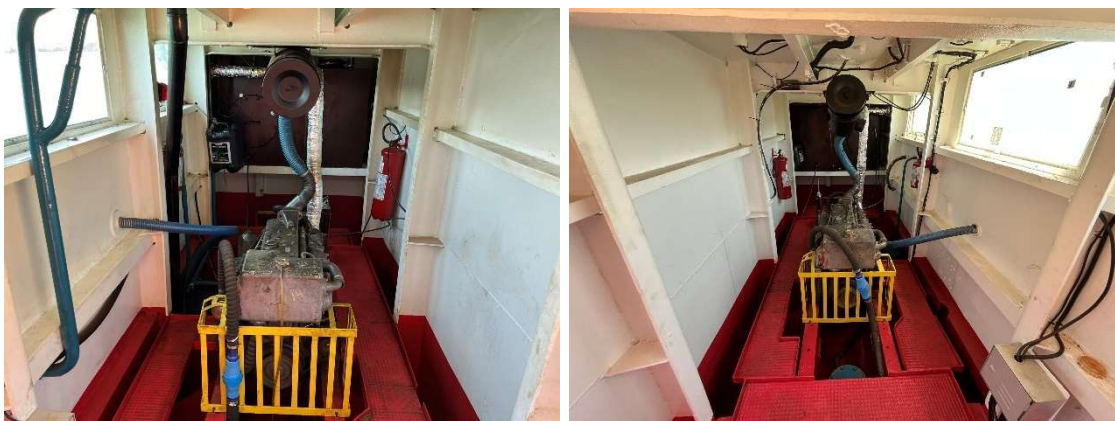
Figura 138 - Porto Fernandes - Balsa Fernandes - Casa de Máquinas
