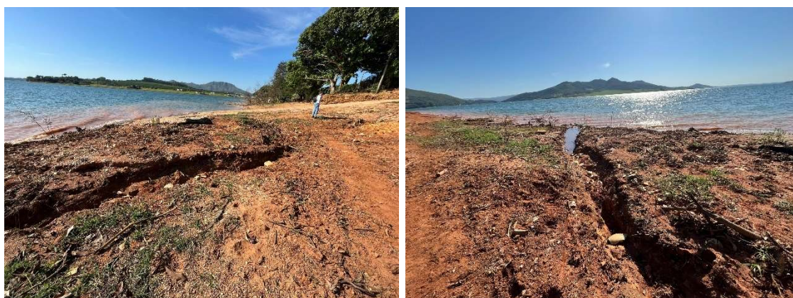
Figura 146 - Porto Itapiché - Pátio do Terminal - Margem Direita – Afundamento Erosivo do Solo
