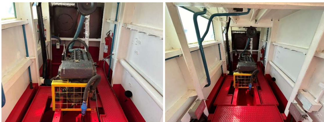
Figura 193 - Porto Itaci - Balsa Águas Verdes – Casa de Máquinas
