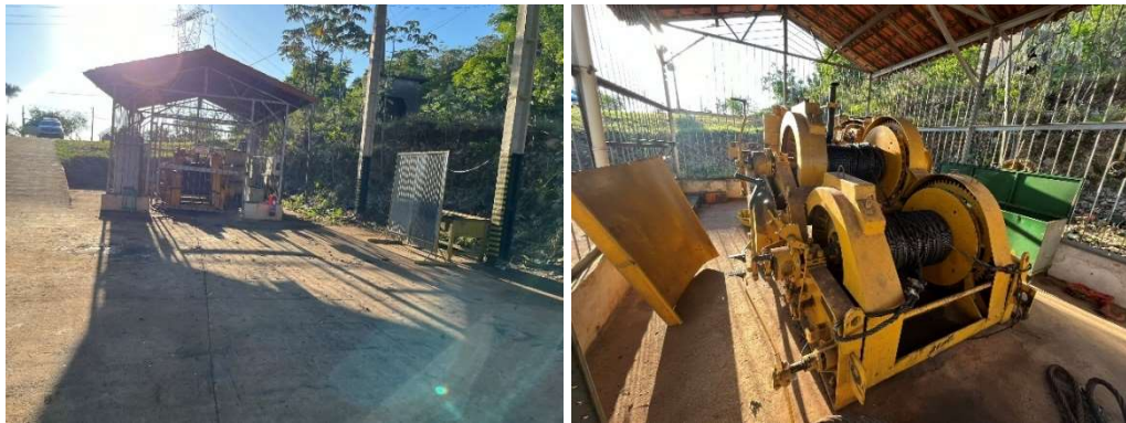
Figura 4 - Estaleiro Furnas - Equipamento Existente - Guincho para Docagem
