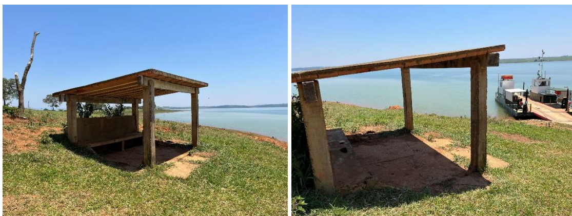
Figura 128 - Porto Fernandes - Pátio Margem Cristais - Estrutura de Apoio a População
