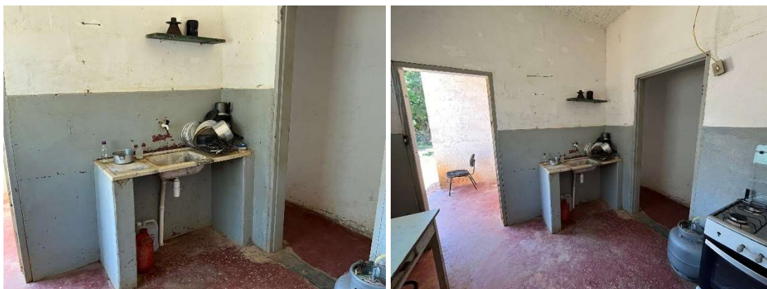
Figura 189 - Porto Itaci - Prédio Apoio - Cozinha - Margem Direita
