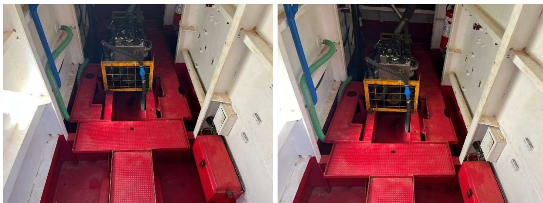
Figura 211 - Porto Águas Verdes - Balsa São Francisco III - Casa de Máquinas
