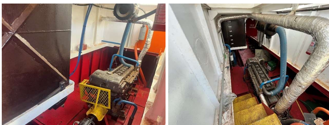
Figura 37 - Balsa São João Batista do Glória - Casa de Máquinas
