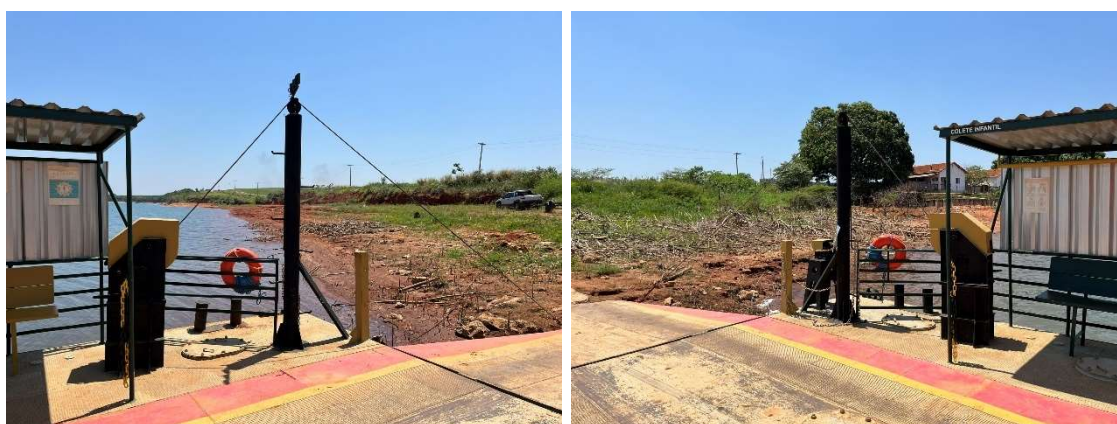
Figura 136 – Porto Fernandes - Balsa Fernandes - Mecanismos Acionamento das Rampas
